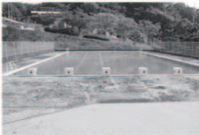
修繕が必要なセンタープール
